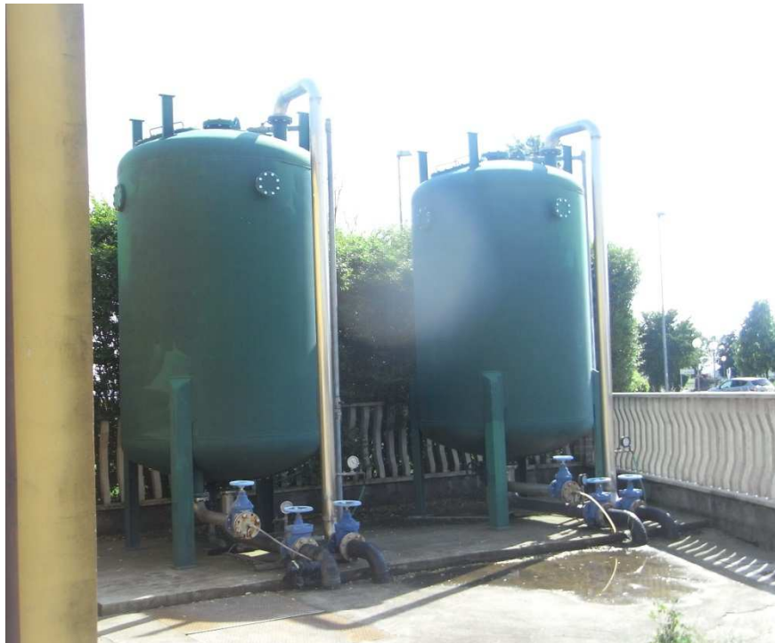
Fig. 7: Filtri a carboni attivi dell'impianto di Castiglione d'Adda
