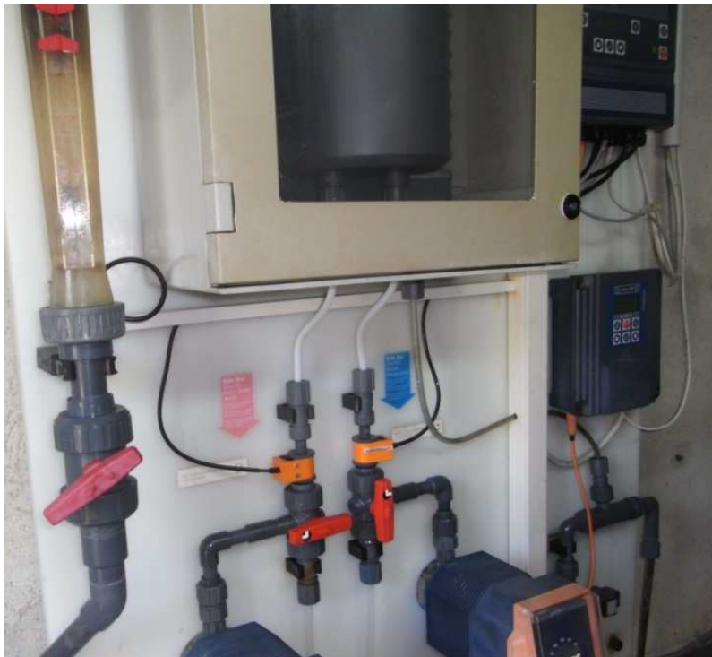
Fig. 5: Impianto di sanificazione della Casa dell'Acqua di Castiglione d'Adda
