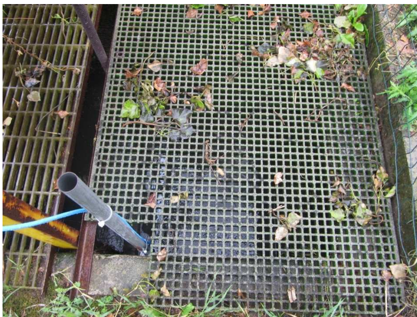
Foto 3-1: Tubo guida posizionato nel pozzetto di derivazione in ingresso all'impianto dove è stata installata la sonda piezo-resistiva (cavo azzurro)
