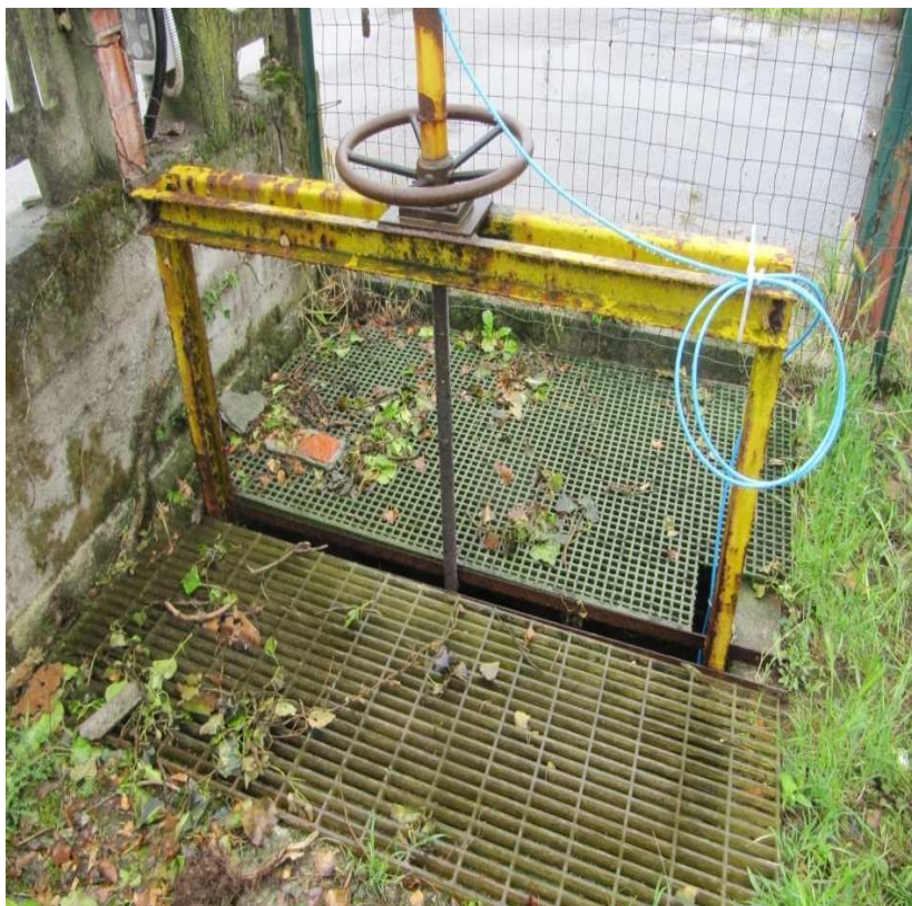
Foto 2-1: Pozzetto di derivazione e scolmatura in ingresso all'impianto
